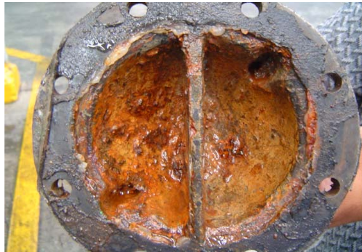
Vista 4.- Tapa de intercambiador de calor a los 60 días de la experiencia sin uso de ningún químico.
