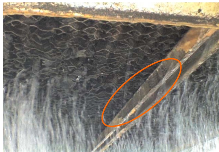
Vista 6.- Vigas de la torre con presencia de corrosión.
