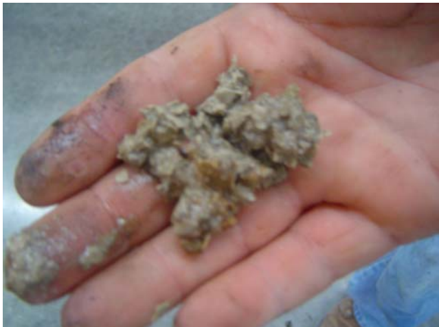
Vista 3.- Incrustaciones removidas fácilmente separadas de la tapa del intercambiador máquina 3.
