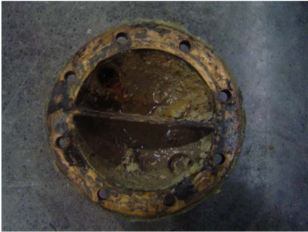
Vista 1.- Tapa de intercambiador máquina 3 con incrustaciones.
