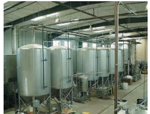
Serbatoi di immagazzinamento Disinfezione dei serbatoi con Catholyte e ANK
