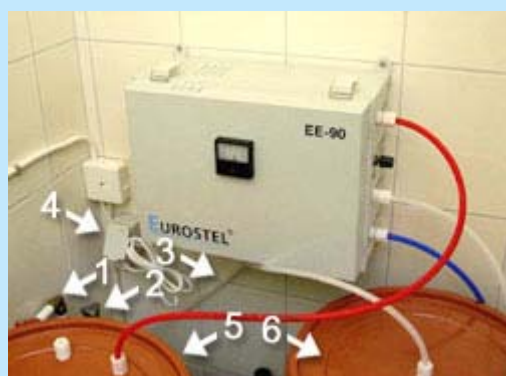
Enviolyte EL-900 in funzione (si possono osservare 30A sull'ampmetro)
